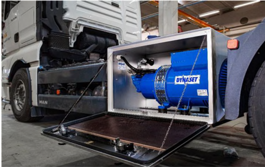
LKW mit einem Hydraulikgenerator, der in einem Seitenkasten eingebaut ist
